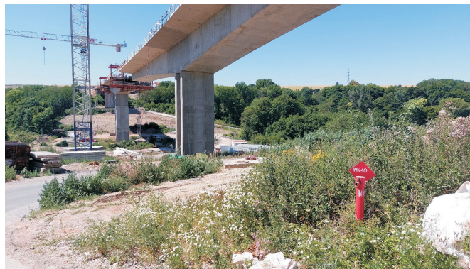
obr. 5 Pohled na svah pod žateckou opěrou z mostecké strany (7/2025)
